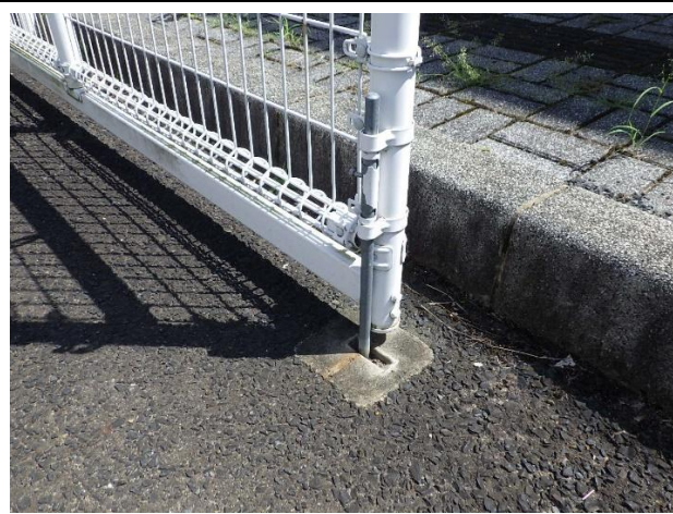
⑤ 公道からの事務所出入口門扉にロックピン あり、従前同様に作動するよう微調整
