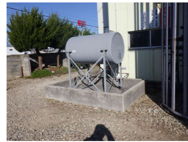
灯油タンク+置場
