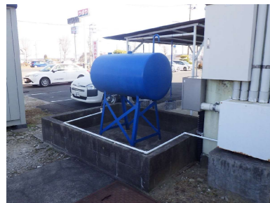
S 灯油タンク+置場
