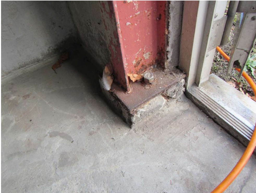
図 10 鉄骨：基礎コンクリート割れ、腐食
