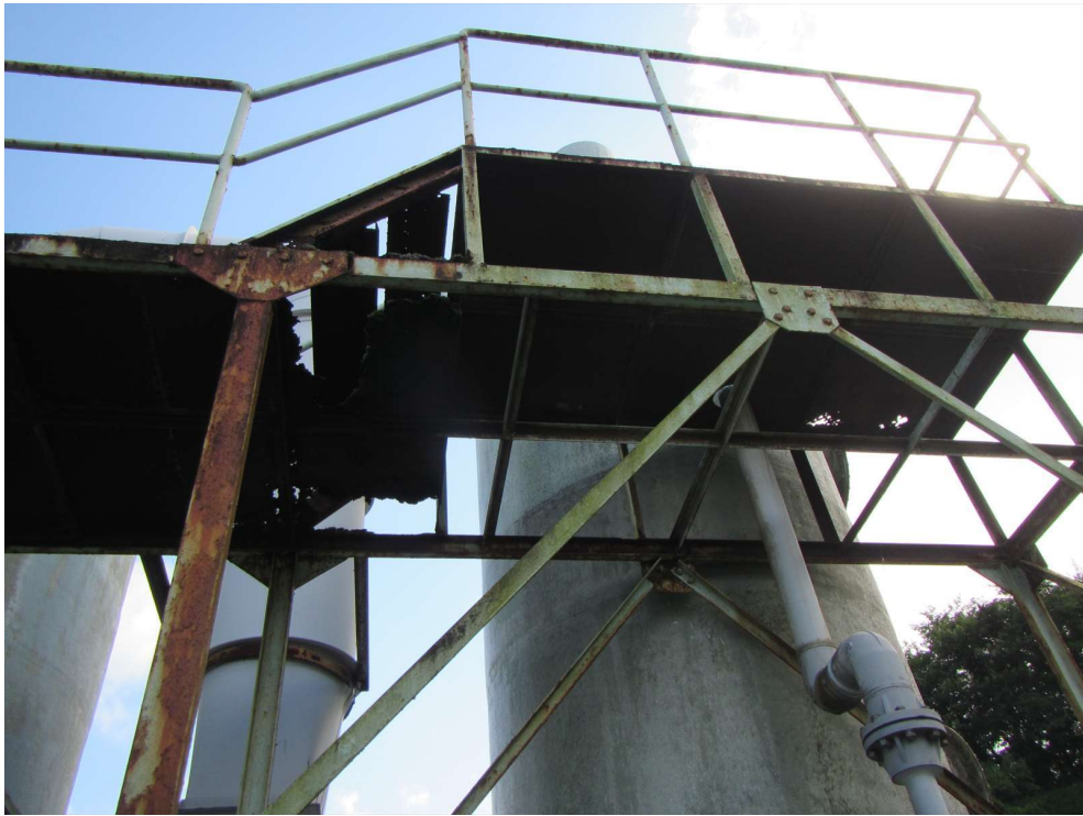
图 12 脱臭装置附近阶段：架台等腐食
