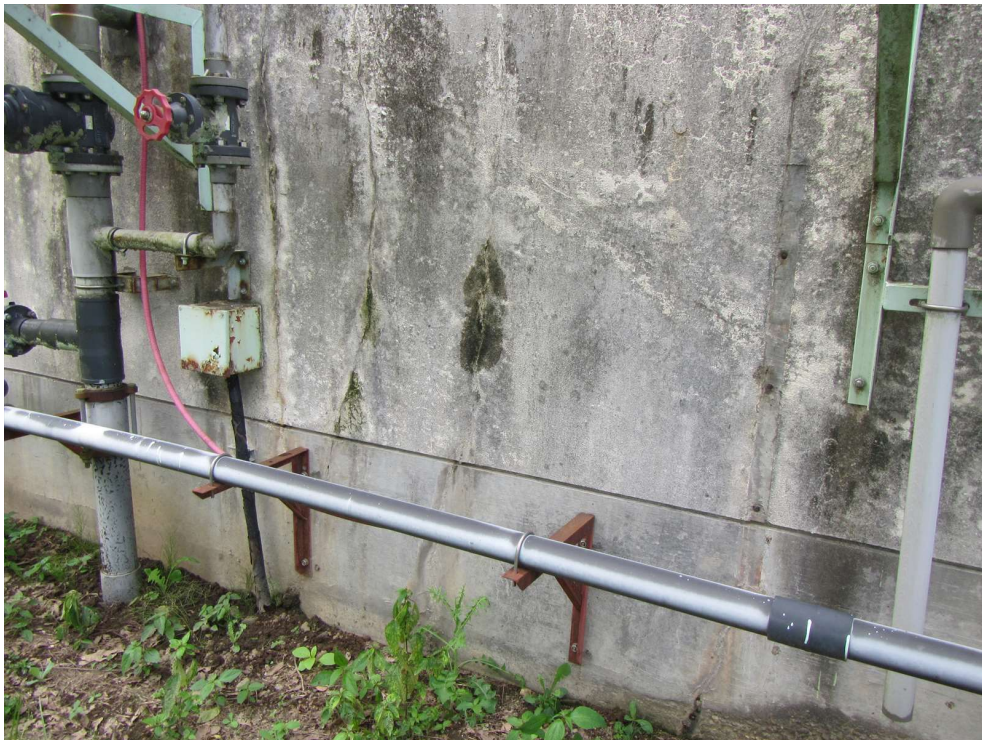
図 11 脱窒素槽外側外壁：クラック、水漏れ跡あり
