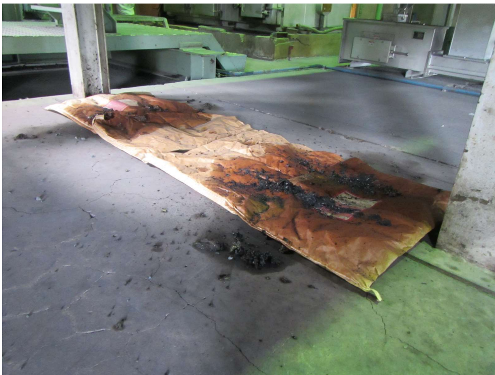
図 7 汚泥乾燥焼却炉：グリース漏れ
