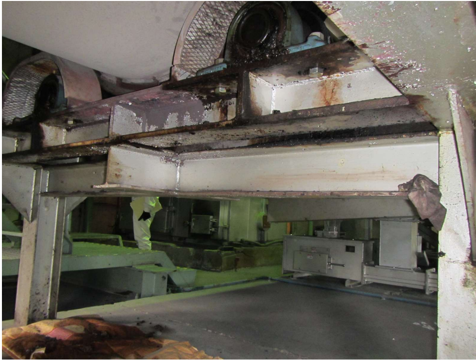
図 6 汚泥乾燥焼却炉：塗装剥がれ、架台発錆
