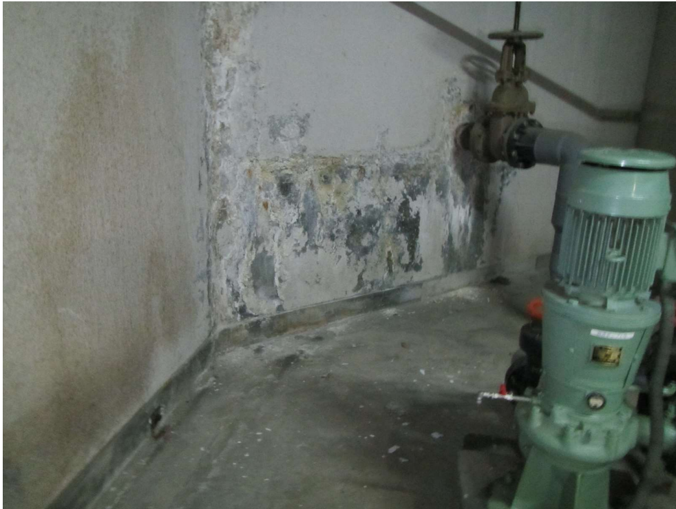
図 8 ポンプ室：壁面腐食
