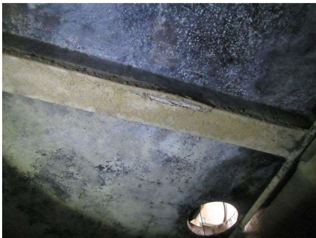
図 5 し尿貯留槽：防食塗装剥がれ、梁部コンクリート割れ
