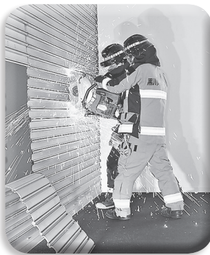
シャッター破壊の様子
